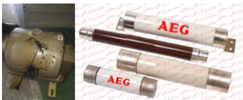
شکل (۱): ترانس ولتاژ ۲۰ KV آسیب‌دیده و فیوزهای اولیه ترانس ولتاژ
