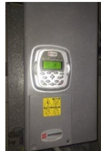
شکل (۱): درایو کنترل دور آسیب‌دیده بر اثر صاعقه
