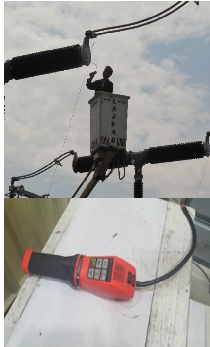
شکل (۸): بررسی نشتی گاز SF6 با استفاده از دستگاه دتکتور نشت یاب گاز SF6
