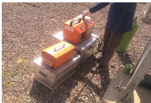
شکل (۵): کمپروسور و تجهیزات تخلیه گاز
